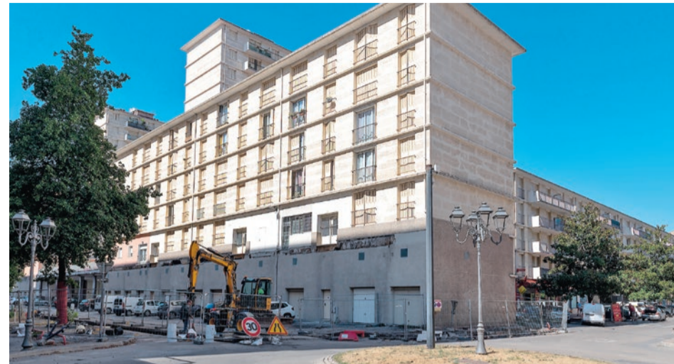
Les pieds d'immeubles du N°21 au N°51 de la Grand'rue Jean Moulin vont être entièrement restructurés pour laisser place des aménagements pratiques, comme des locaux commerciaux et associatifs ou des rangements pour les vélos, tout en agrandissant les halls d'entrée.
